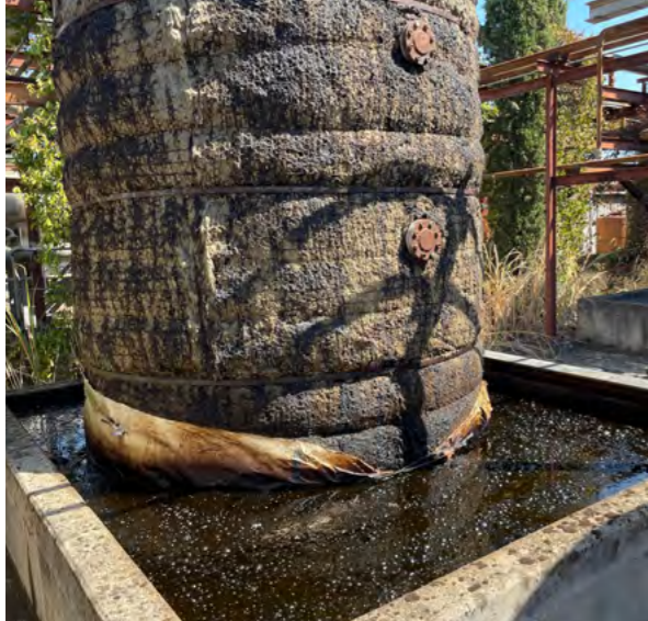
La situazione delle vasche di contenimento poste all'interno della ditta Sun Oil prima dell'intervento di bonifica attualmente in corso.
